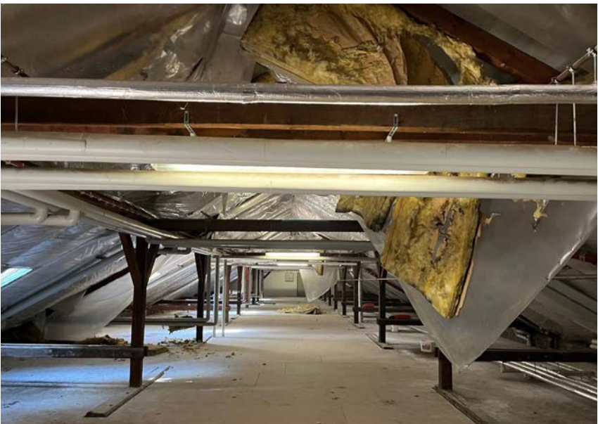
Dachgeschoss - Schäden durch Waschbärbefall
