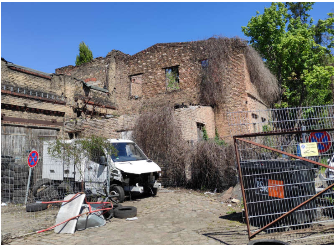
Abbildung 57: Ruinöses Bauteil der Bastianstraße 17 (2023)
